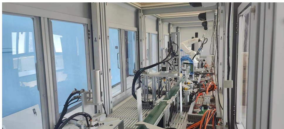
柔性产线内部设备
